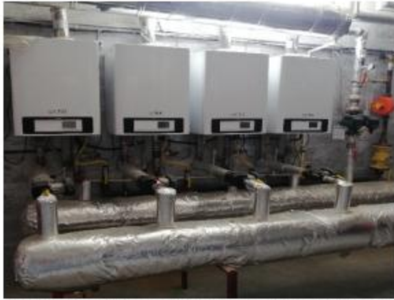
Şekil 5.1.1 Mevcut Doğalgaz Yakıtlı Kazan
