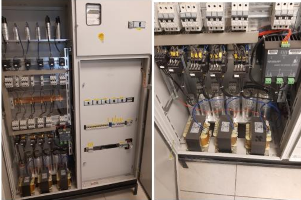
Şekil 6.1 Ana Dağıtım Panosu
