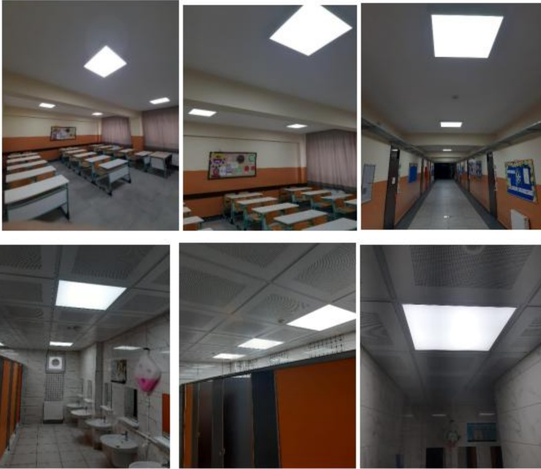
Şekil 6. 2 Bina İçi Aydınlatma Armatürleri
