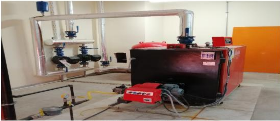
Şekil 5.1.1 Mevcut Doğalgaz Yakıtlı Kazan
