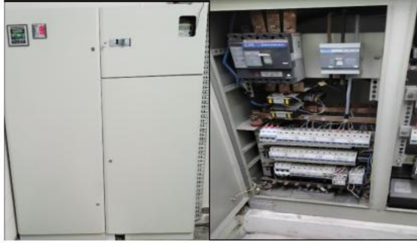
Şekil 57. Ana Dağıtım Panosu
